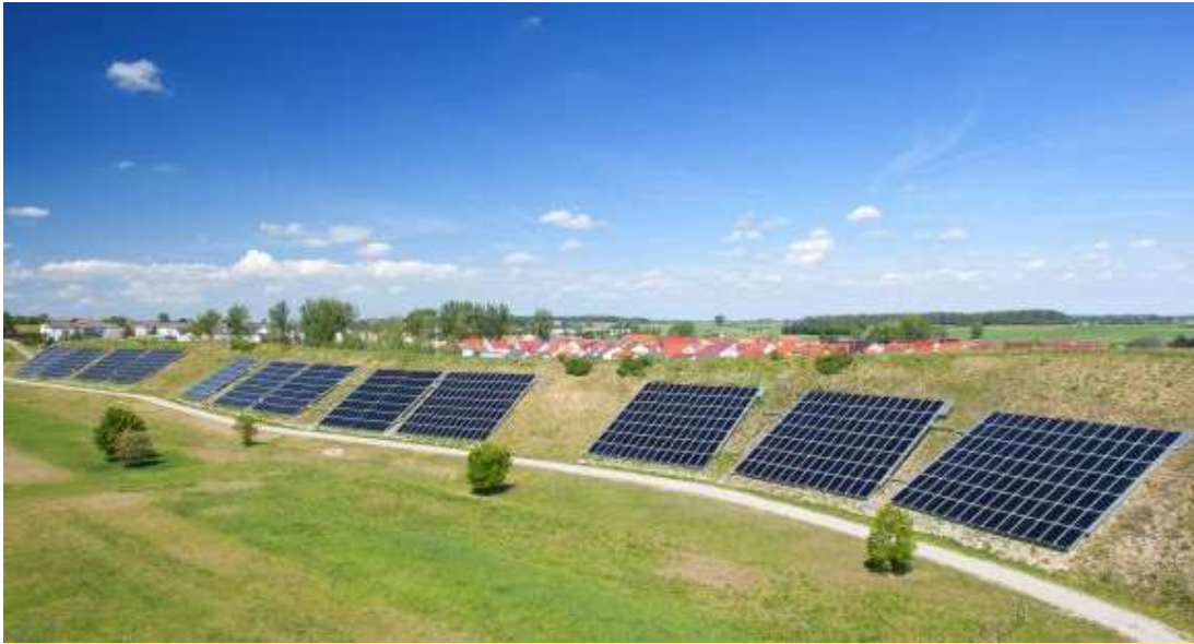
Abbildung 4-4 Freiflächen-Solarthermieanlage in Crailsheim (Quelle: (VDE VERLAG))
