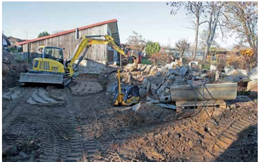
Im Außengelände wurden die Fundamente des alten Filterhauses ausgegraben, um Platz für die neue Werkstatt zu machen.
